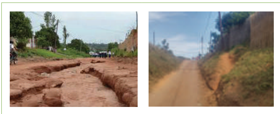
Figura 9. Efeitos de erosão na cidade de Xai-Xai, 2019
